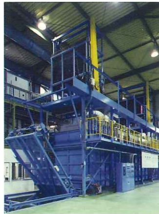
三重工場 メッキ設備
