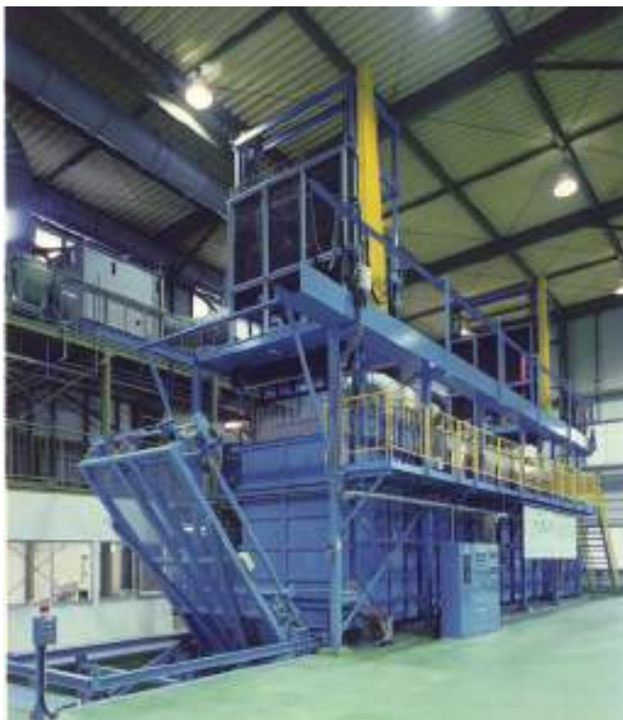
三重工場 メッキ設備
